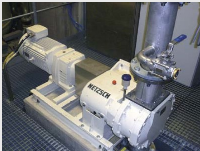
TORNADO® T1 naudojamas popieriaus fabrike. Kaolino cisternos iškraunamos 75 m 3 /h greičiu, kai slėgis siekia iki 4 bar.
